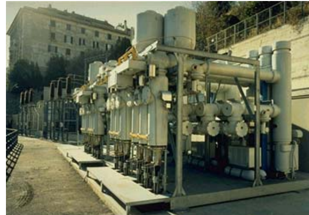
Stazione blindata a 145 kV con isolamento in SF6
