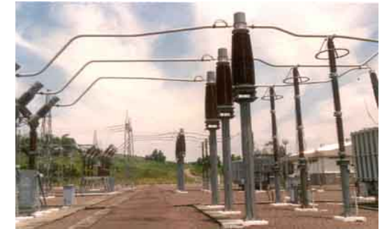
Apparecchiature con isolamento esterno in porcellana (TA, TV, passanti, interruttori)
