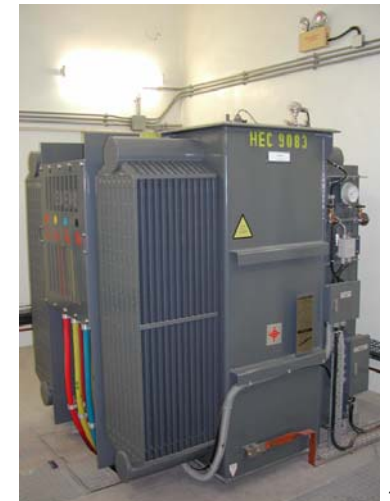
Trasformatore 22 kV/390 V, 1500 kVA, isolato in SF6
